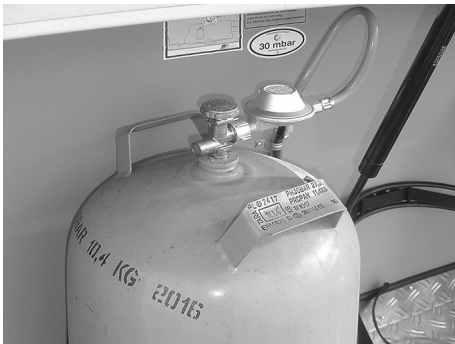
Afb. 86: gasfles met drukverminderingssklep
