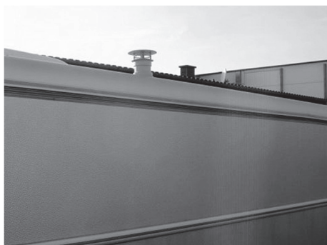
Afb. 82: Schoorsteen voor verbrandingsgassen van de gasverwarming
