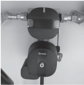
Afb. 78: Gasinstallatie (met Eis-Ex en display op afstand)
