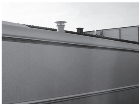
Afb. 84: Schoorsteen voor verbrandingsgassen van de gasverwarming
